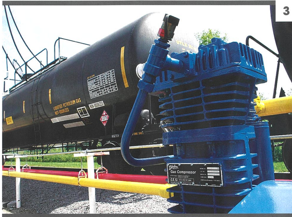
3. kép Robbanásbiztos kivitelű gázkompresszor.
