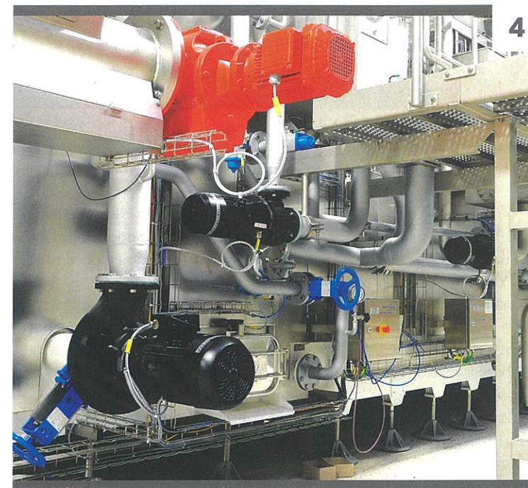
4. ábra: Zónaszámítás és zónatérkép nélkül nem lehet robbanásbiztos berendezést kiválasztani, nem lehet megfelelő villámvédelmet készíteni.
